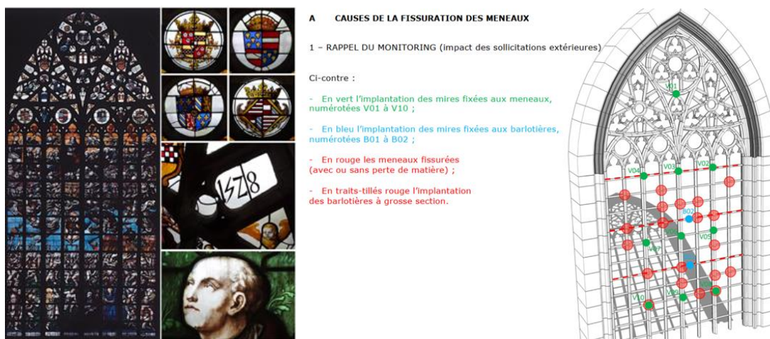
Het Laatste Oordeel – Monitoring : scheurvorming in de monelen (documenten uit het aanvraagdossier)
