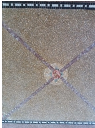
La salle de billard, avec ses grandes baies, son sol en granito et ses vitraux ©CRMS
