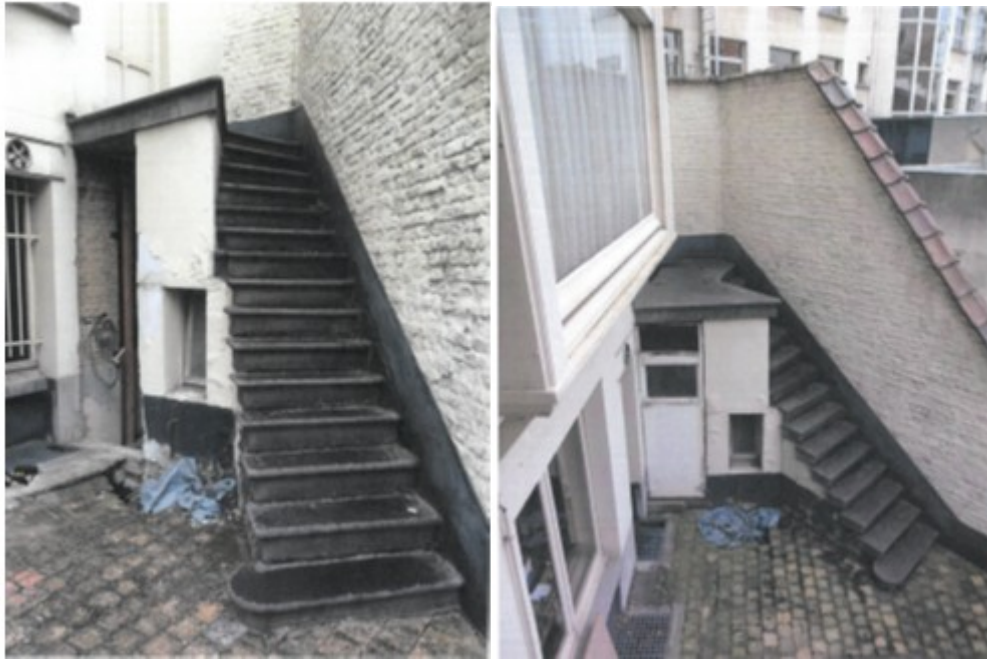
Bestaande toestand van de trap, de onderliggende ruimten en de koer © B. Van der Wee
