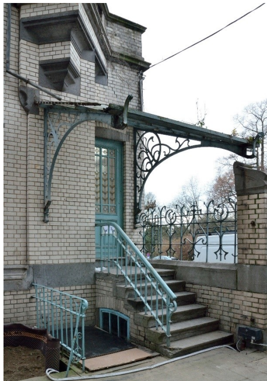
Détail de l'auvent et des ferronneries de l'entrée latérale (©Atelier d'Architecture du Congrès)
