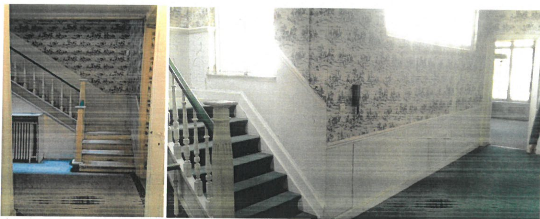
A gauche : Vue sur l'escalier de service depuis le rez-de-chaussée. Le projet prévoit sa démolition en vue d'y placer un ascenseur. A droite : l'escalier de service au deuxième étage. Le projet prévoit de démolir l'espace à droite de l'escalier afin de prolonger l'escalier principal. Photos CRMS
