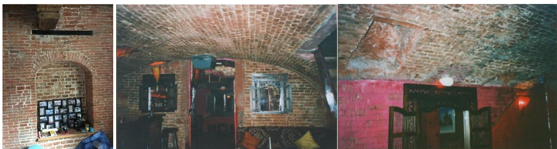
A gauche, présence d'une niche dans la maison arrière (photo DPC © urban.brussels, 2022). Au centre et à droite, état des caves en 2006 (photos DPC © urban.brussels, 2006).
