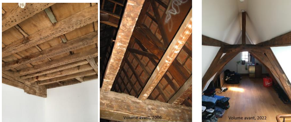
A gauche, poutraisons et gîtages en chêne. Au centre et à droite, charpentes avant et après rénovation (photos DPC © urban.brussels, 2006 et 2022)
