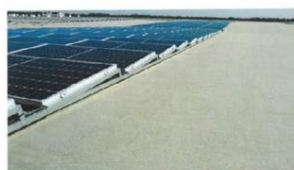
Photos de panneaux solaires avec support incliné à 5°
