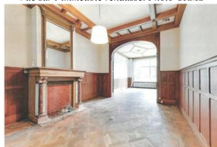
Photo des décors intérieur du rez-de chaussée. Image tirée du dossier de demande
