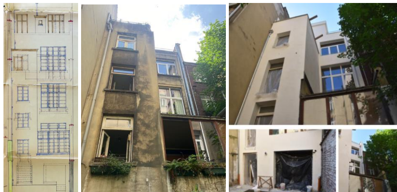
A gauche, élévation de 1935. Au centre, la façade avant travaux. A droite, chantier en cours (extraits du dossier)
