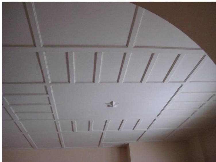
Rez-de-chaussée, plafond de la salle à manger (Photo E. Hennaut - L. Liesens /AAM, 2010)
