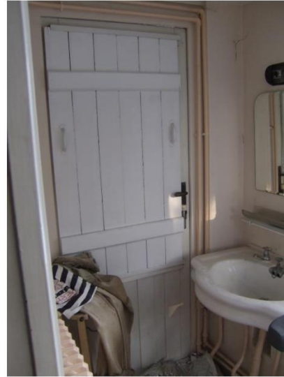
Étage, ancienne terrasse, actuellement salle de bain (Photo E. Hennaut - L. Liesens /AAM, 2010)
