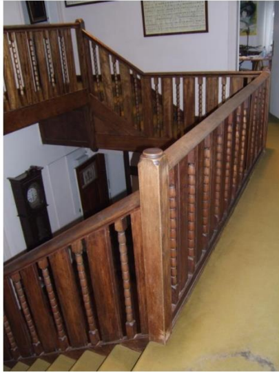
Hall, mezzanine vers la façade avant (Photo E. Hennaut - L. Liesens /AAM, 2010)
