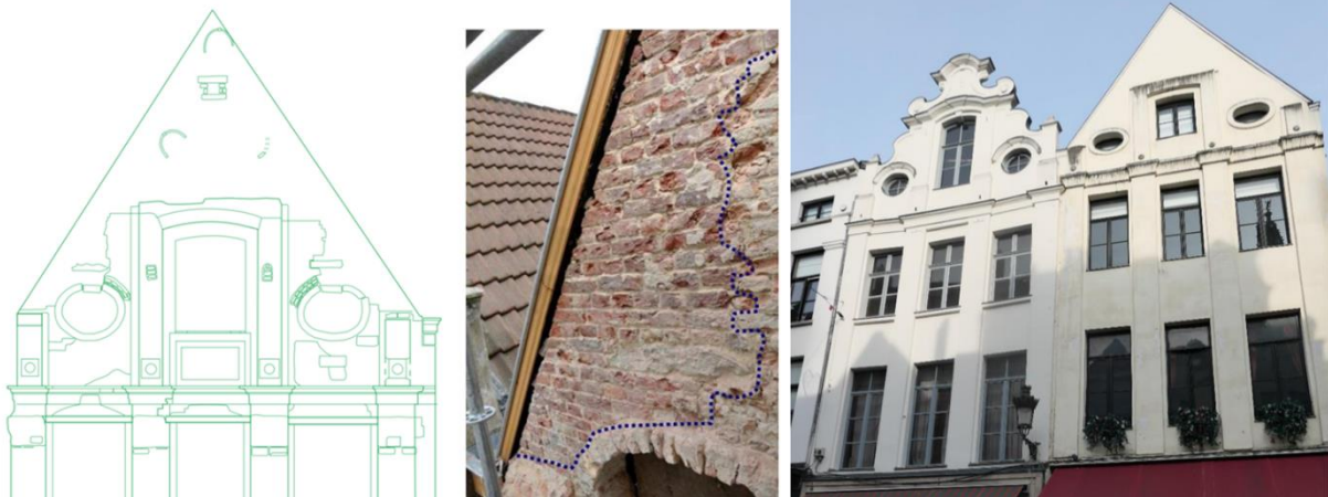
A g. et au centre : lors du décapage de la façade, le relevé des matériaux (format des briques) a permis de constater les différentes maçonneries : pignon originel et transformations du 19 e s. (relevé et photo ©DPC/ Urban)
