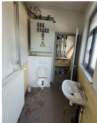
Intérieur du local chaufferie
