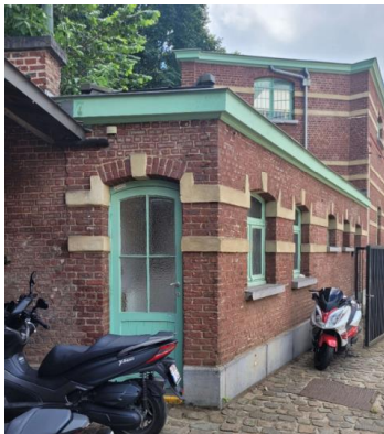
Photo du local chaufferie Images extraites du dossier de demande.
