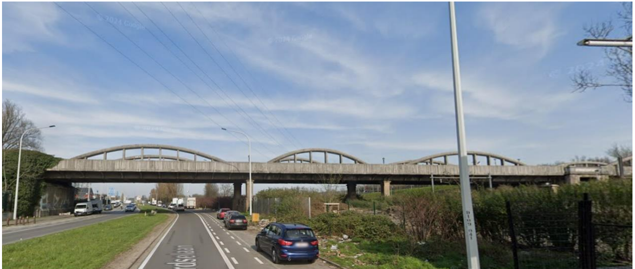
Images du pont en 2009 (en haut) et 2023 (© Google Streetview), luminaires existants (photo CRMS, 2024)
