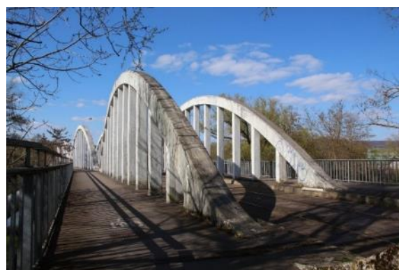
Pont Bow-Strings de Pompey (dépt. Meurthe & Moselle), 1951, construit pour relier l'usine des aciéries de Pompey au chemin de fer situé de l'autre côté de la Moselle
