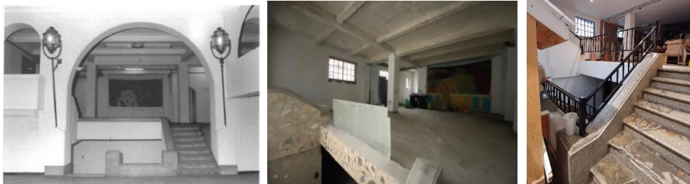
A gauche, l'escalier menant à la mezzanine flanquée de part et d'autre des luminaires Art Déco protégés, aujourd'hui disparus (photo L. Nagels @ Sint-Lukas Archief Brussel, 2018). Au centre, la démolition partielle du garde-corps de la mezzanine (photo extraite du dossier). A droite, vue actuelle de la mezzanine, l'escalier en granito et les nouvelles ferronneries (photo CRMS, septembre 2024)
